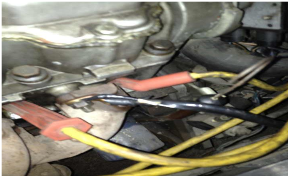
FIGURA 22: CABLES DE ALTA
