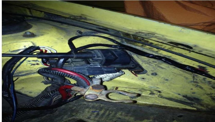
FIGURA 21: CABLES DE BATERIA
