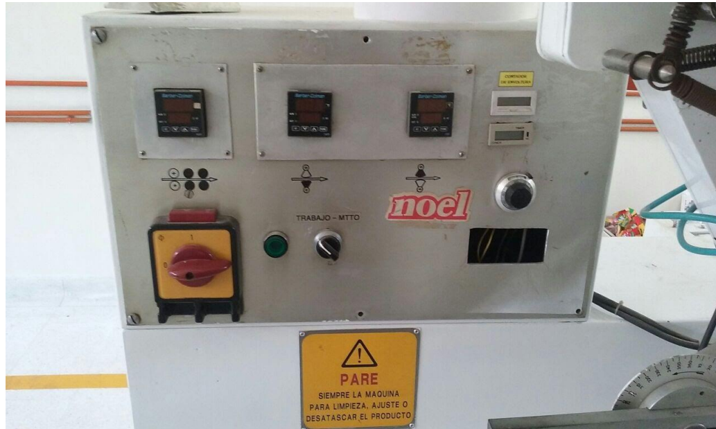
Figura 10. Tablero principal de la empacadora
