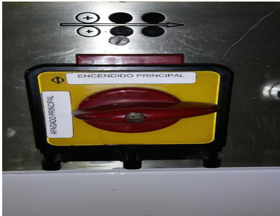
Figura 14. Encendido y apagado principal
