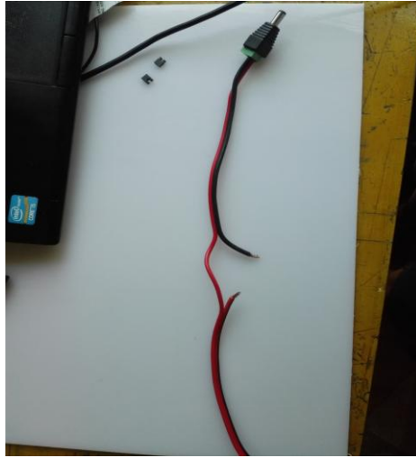
Figura 55 Empalme de cables de terminales de la fuente Fuente: Foto tomada por el autor
