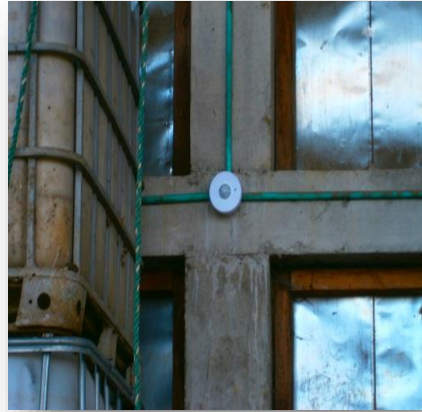
Sensor movimiento interno bodega 1
