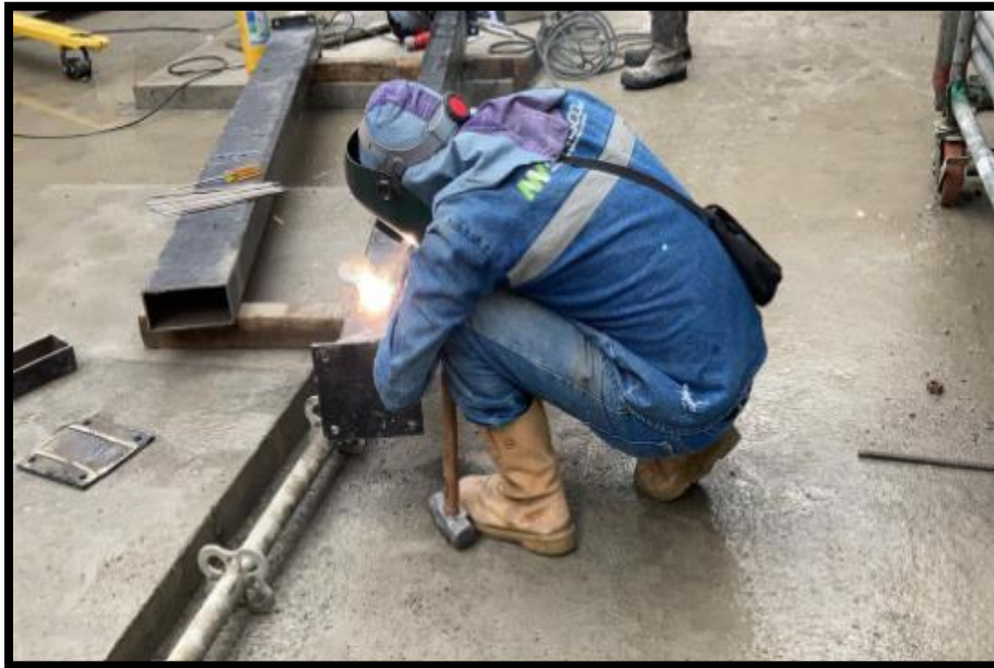
Figura 6. Reproceso por soldadura
