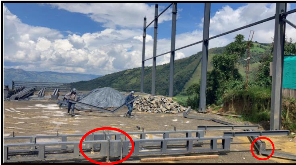
Figura 7. Estructura con daños debido a corrosión
