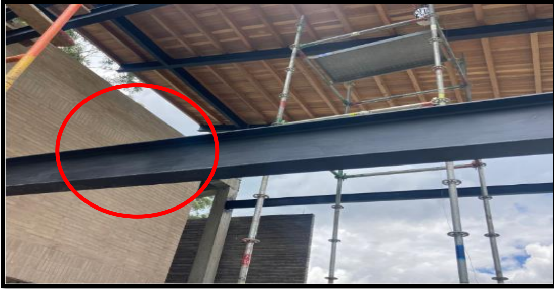
Figura 5. Diferente tono de pintura en estructura
