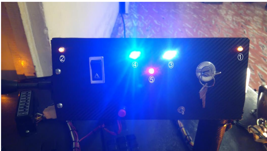
Figura 55. Luces led del tablero encendido.
