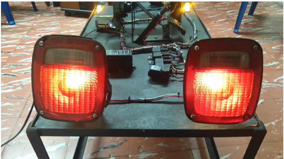
Figura 50. Verificación luces diurnas traseras.
