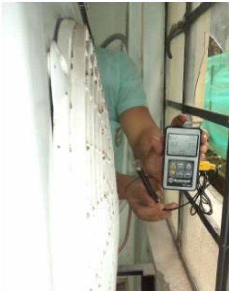
Figura 15. Medición temperatura entrada condensador equipo mini-Split laboratorio de refrigeración IUPB.
