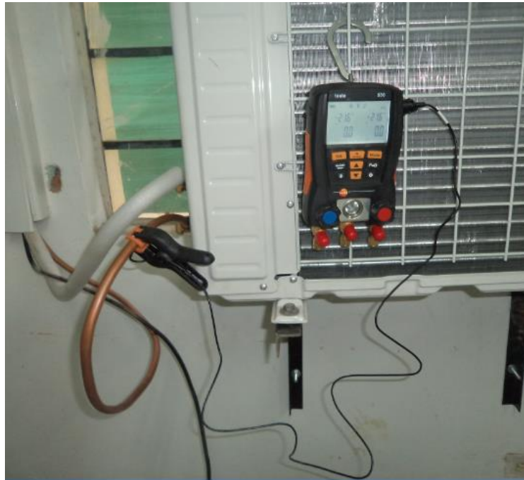
Figura 20. Sonda de temperatura de equipo testo 550 para medición sobrecalentamiento y subenfriamiento salida evaporador equipo mini-Split laboratorio de refrigeración IUPB.
