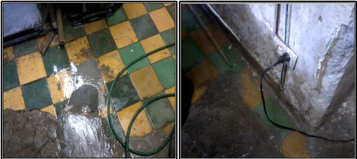
Figura 33. Riesgos presentes en el área de desmolde
